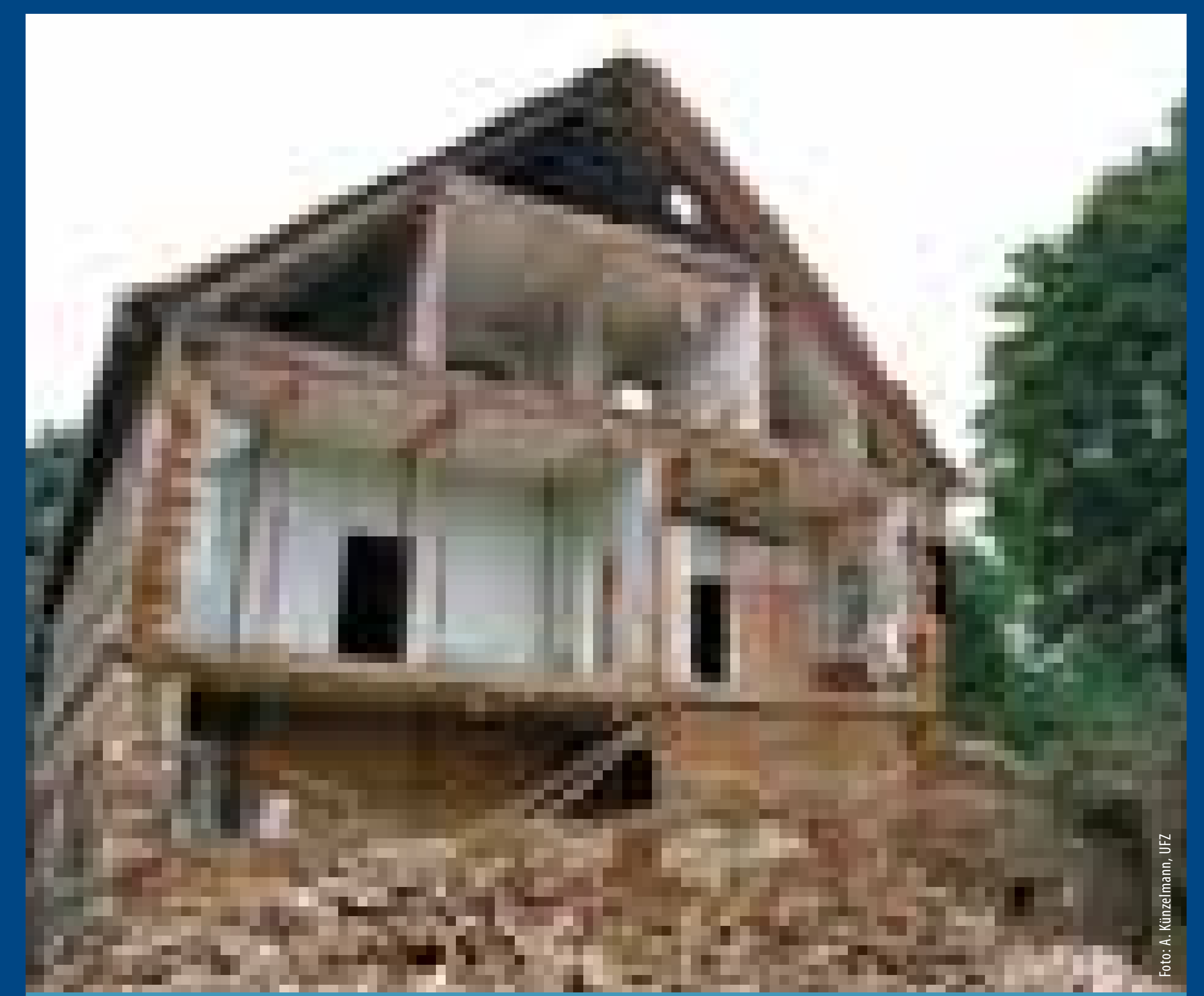
Schreckensbilanz: zerstörtes Haus in Grimma
