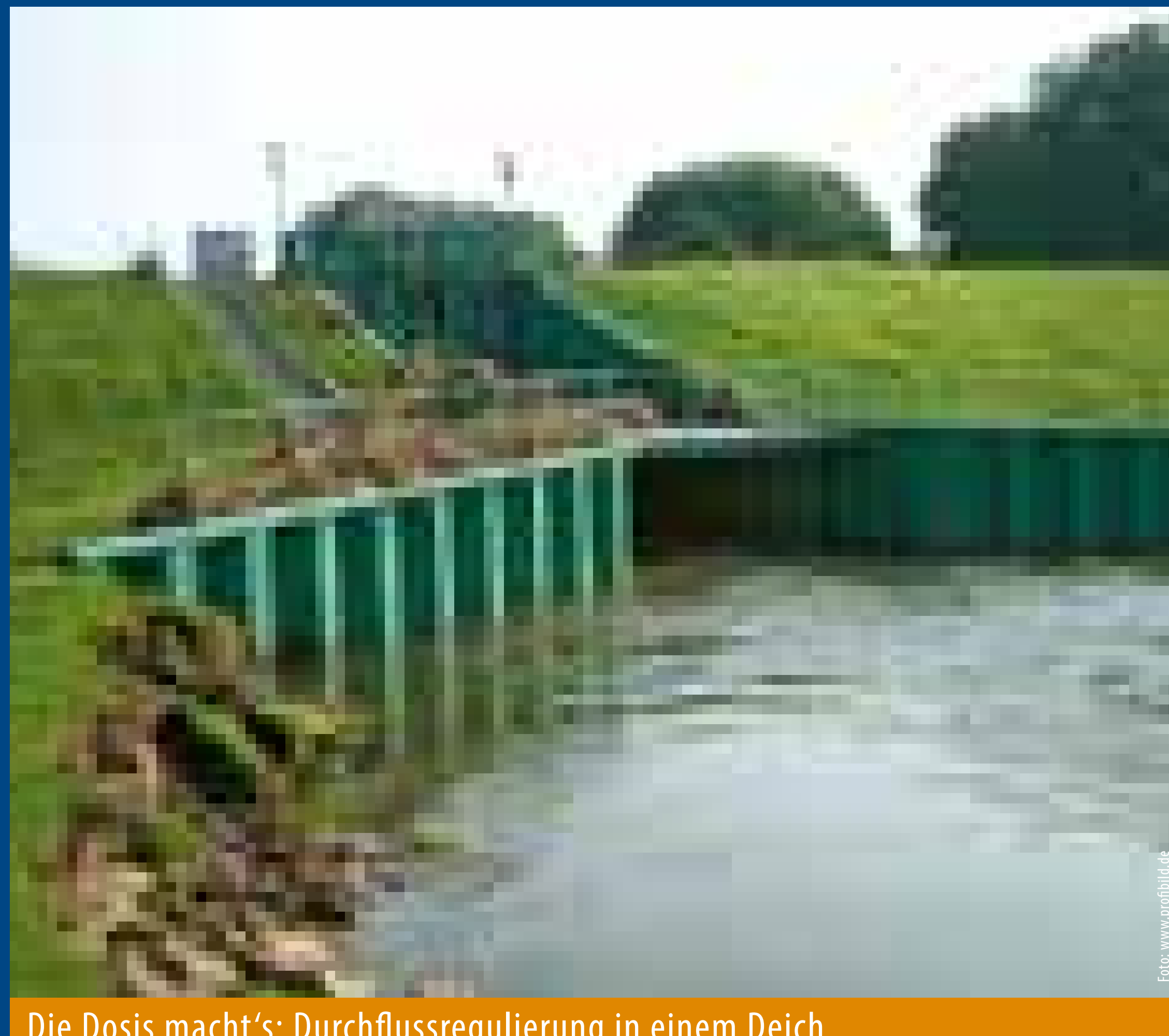
Die Dosis macht's: Durchflussregulierung in einem Deich
